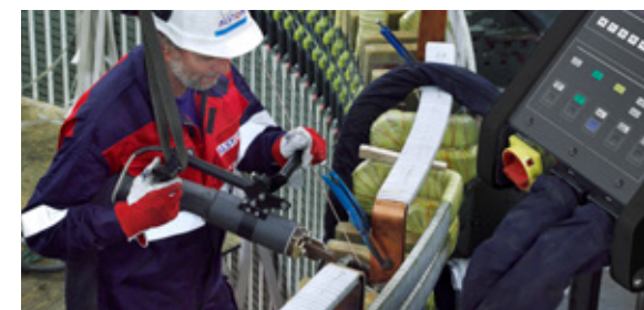
Ein ENRX Minac lötet Generatorwicklungen. Die Mobilität von Minac und der tragbare Transformator machen es möglich auch an schwer zugänglichen Stellen zu löten.
